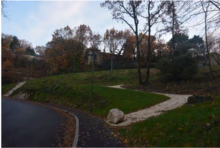
Travaux d'éclairage public, chemin de Beauregard (29 457 HT) et sur la RD533 (13 705 HT) dans le cadre des réaménagements de voirie réalisés par la CCRC
